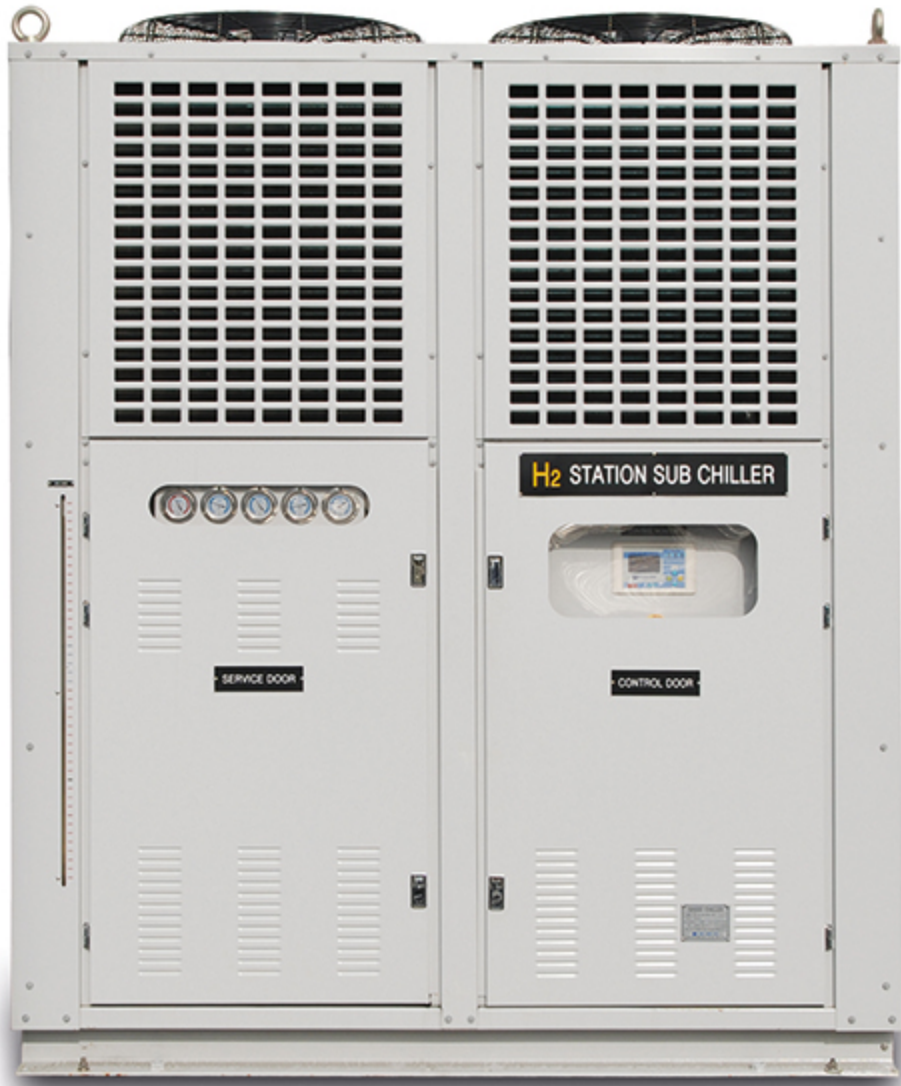
공냉식 H 2 SUB CHILLER
